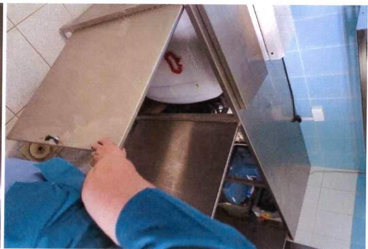
Lp. 07 - Stacja uzdatniania wody (4)
