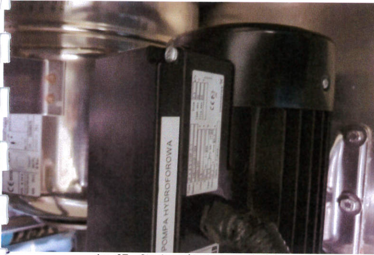
Lp. 07 - Stacja uzdatniania wody (3)
