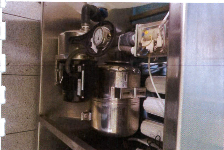
Lp. 07 - Stacja uzdatniania wody (1)
