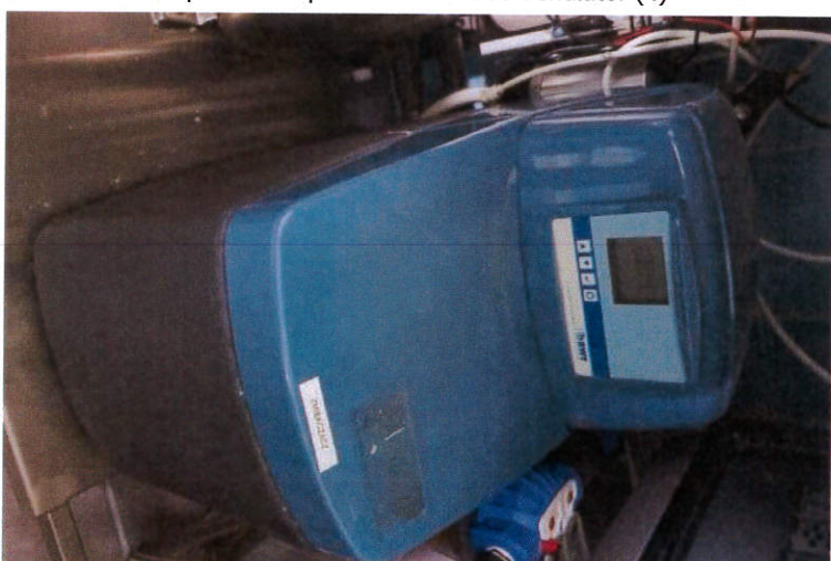
Lp. 07 - Stacja uzdatniania wody (2)
