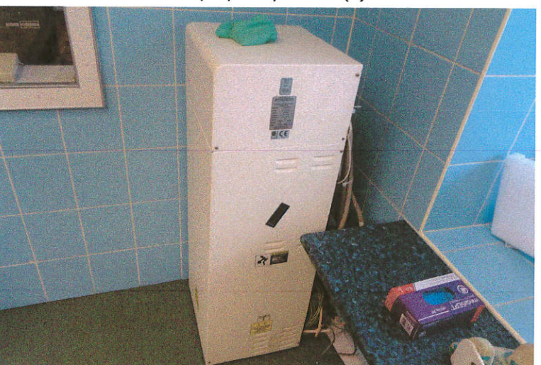
Generator wysokiej częstotliwości (2)
